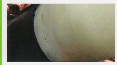
Schmitze/Einkerbungen in das Isoliermaterial
