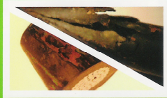
Halbleitungsschicht Defekt / Chemische Zersetzung
